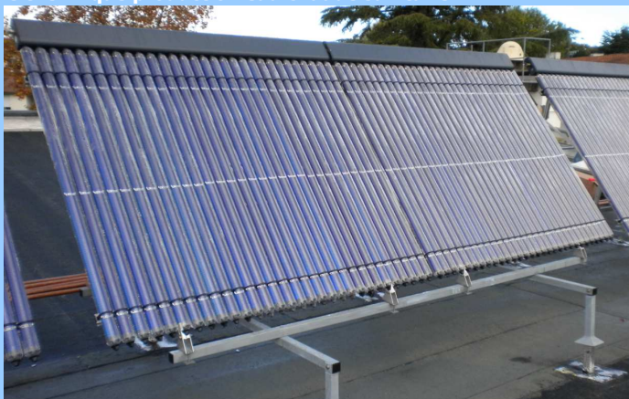
Solaire thermique production eau chaude sanitaire
