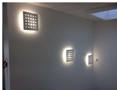
ECLAIRAGE INDIRECT DES ESCALIERS
