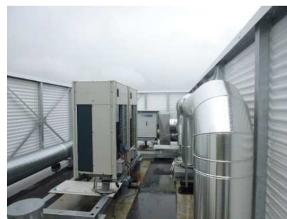
2 POMPES A CHALEUR AIR/AIR REVERSIBLES
